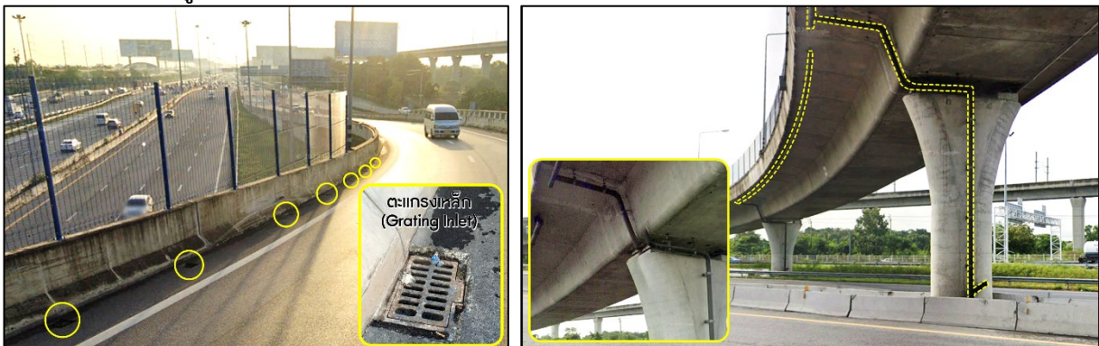
รูปที่ 28 ระบบระบายน้ำบนสะพาน
